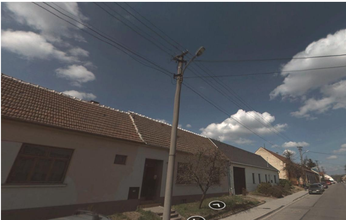
Obrázek č. 15: Veřejné osvětlení a elektrické vedení v obci; zdroj: Mapy.cz .
